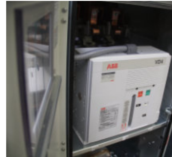
Hinter den Fronttüren verbaut sind meist Vakuum-Leistungsschalter Typ VD4, Fabrikat ABB/Calor Emag (andere Typen auf Anfrage).
