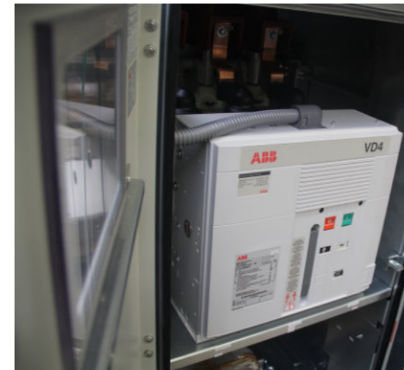
Hinter den Fronttüren verbaut sind meist Vakuum-Leistungsschalter Typ VD4, Fabrikat ABB/Calor Emag (andere Typen auf Anfrage).
